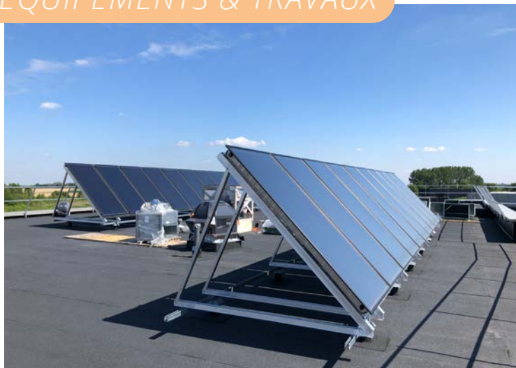
Panneaux solaires en toiture
